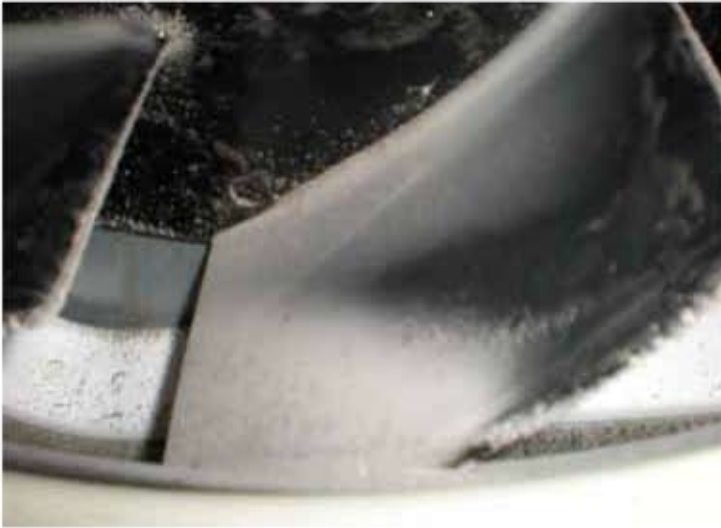
バックヤード ファン 重位の埃の付着が見られます レベル5の汚れ進行中
